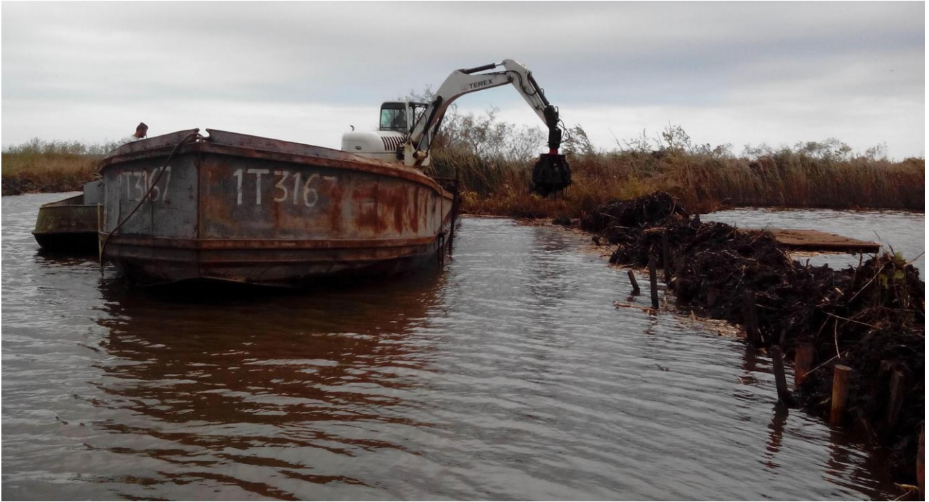
Figura 3: Lavori di costruzione dell'argine per separare il canale del Porto dall'area del “Chiarone”: Fase di riempimento con terra di scavo a opera di un escavatore posizionato su chiatta galleggiante.
